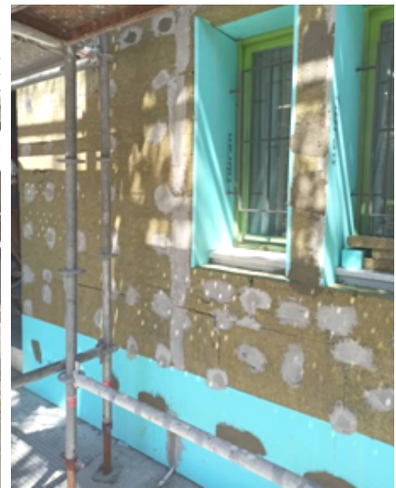
2: Η θερμομονωτική αυτή πρόσοψη όπως εφαρμόστηκε σε κτίριο της Θεσσαλονίκης ακολουθώντας τις ίδιες κατασκευαστικές λεπτομέρειες που ελέγχθηκαν στο εργαστήριο
